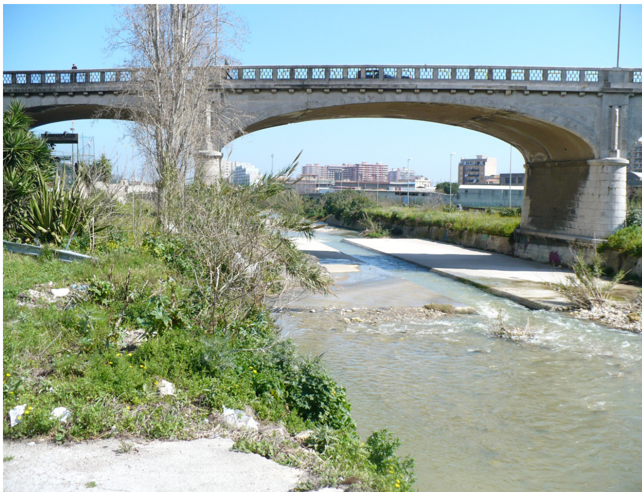
Foto 1- Aspetto degli effetti della cementificazione sui valori naturalistici del tratto fluviale dal ponte Oreto alla foce, evidenziati dalla canalizzazione dell'alveo, dall'assenza di vegetazione alofitica, dal carattere ruderale della vegetazione delle rive e dalla presenza di specie esotiche invasive.
