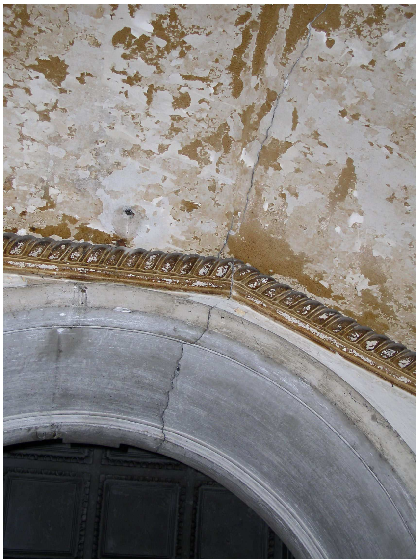
Particolare lesioni riscontrate
