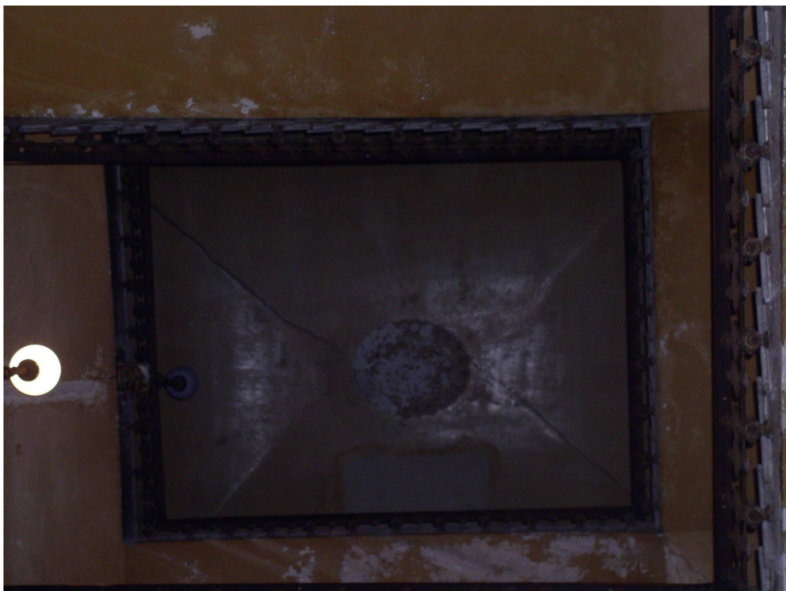
Particolare lesioni riscontrate
