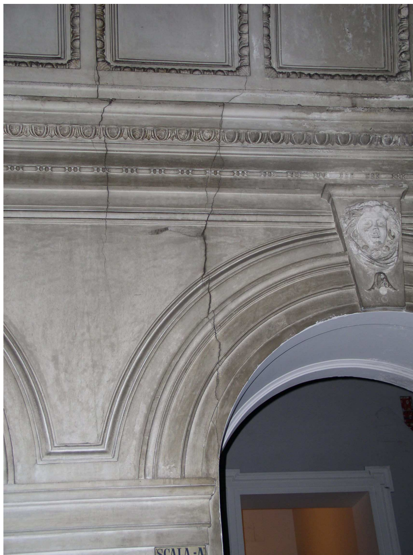
Particolare lesioni riscontrate
