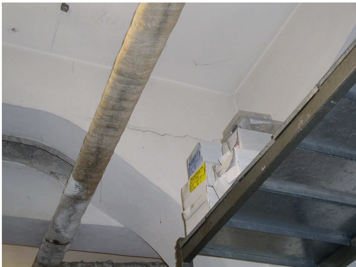
Lesione sulla trave in corrispondenza del giunto con l'edificio I.19
