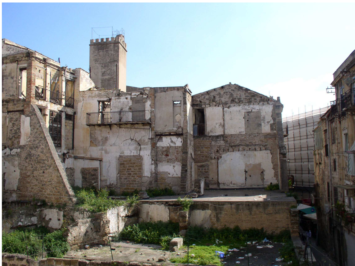
Vista dall'alto dei resti dell'immobile
