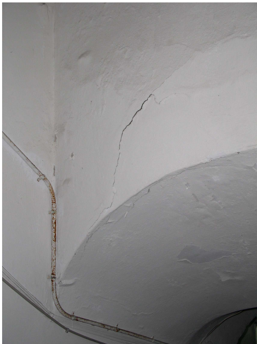
Lesione arco del vano scala al piano primo
