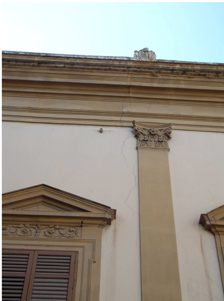
Particolare di una lesione verticale sul prospetto di Piazza Croci dei Vespri
