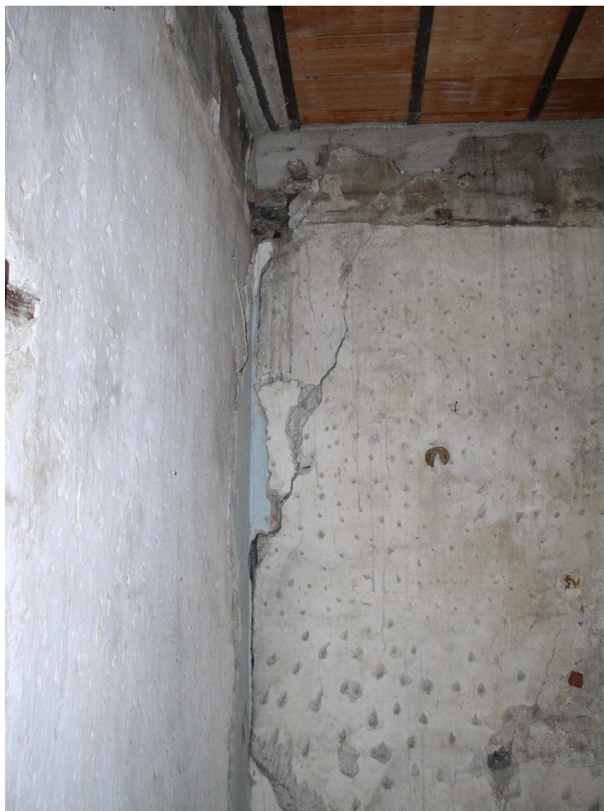
Lesione sulla muratura portante
