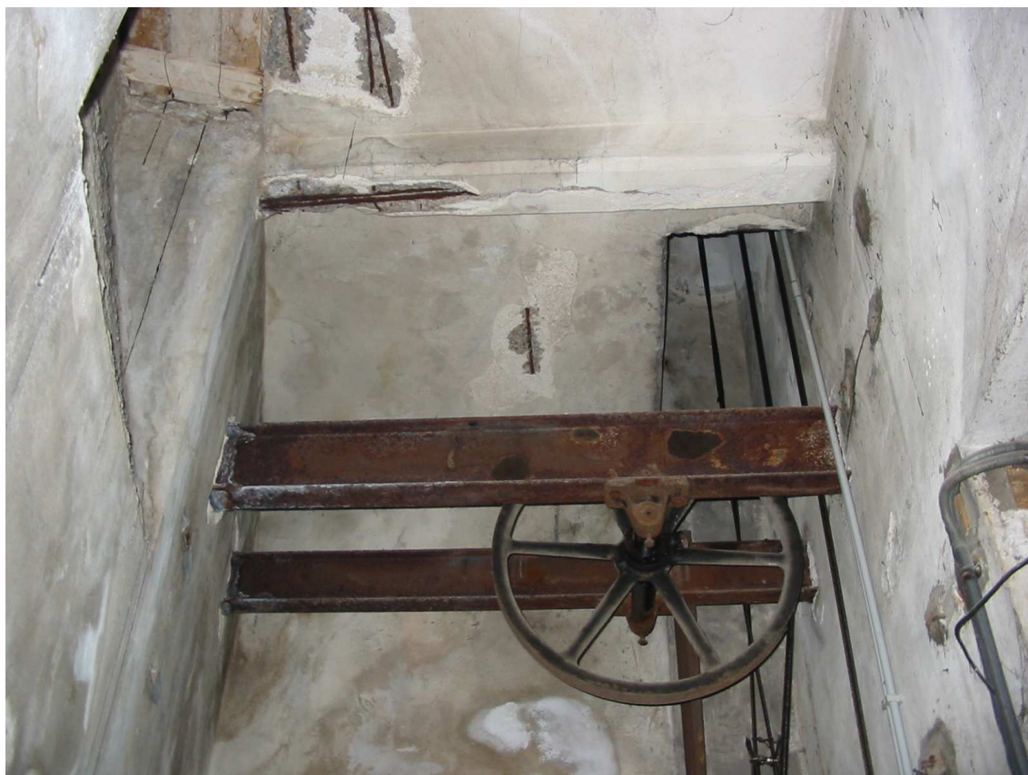
Locale cantinato (particolare dell'organo dell'ascensore)
